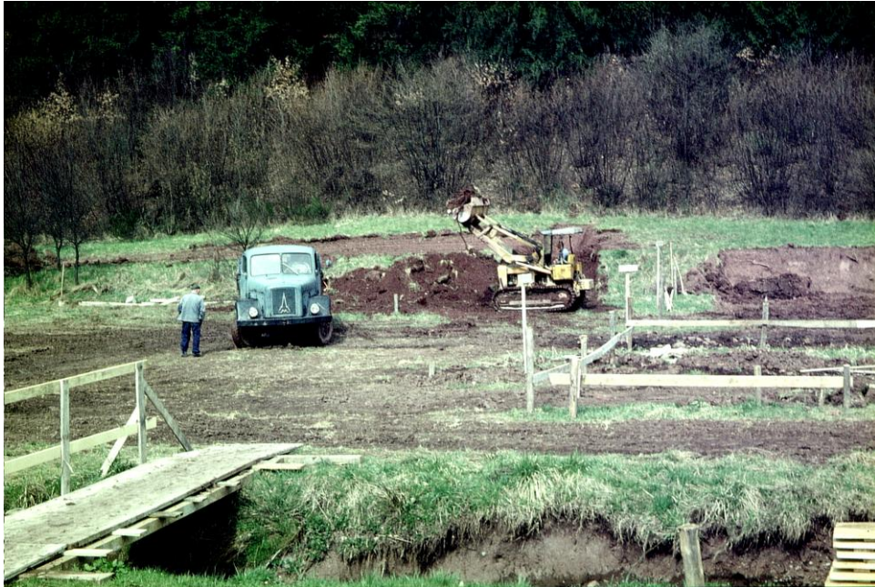
Gelände der Kläranlage bei Baubeginn 1970. Den Bauauftrag hatte die Firma Robert Heidrich aus Nahbollenbach. Der Magirus-LKW gehörte dem Transportunternehmer Paul Kurz aus Kirchenbollenbach, der für die Firma Heidrich den Erdaushubtransport ausführte. Die Laderaube wurde von Heinz Fey aus Kirchenbollenbach gefahren.
