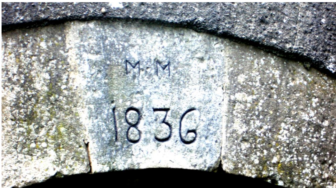
Die Jahreszahl 1836 und die Initialien M.M. im Schlußstein des Brückengewölbes der Brücke über den Steinbach am Weiherdamm.
