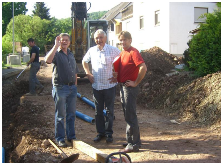
Beim Straßen-, Kanal – und Wasserleitungsbau 2008 in der Mittelbollenbacherstrasse. Die Bauleiter von links: Dipl.-Ing. Fellenzer, Stadtbauamt, Dipl.-Ing. Schunck, Fa. Köhler, Oberreidenbach und Dipl.-Ing. Olaf Heinz, Planer und Bauleiter des Bauprojektes. Rechts das Haus von Wolfgang Theobald.
